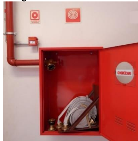
Figura 22 – Detalhe de hidrante.
