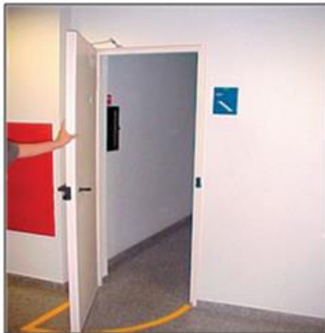
Figura 15: PCF em corredor.
