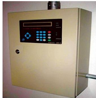
Figura 20: Central de alarme de incêndio.
