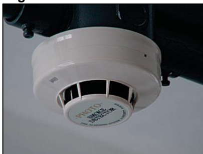
Figura 17: Detector de incêndio.
