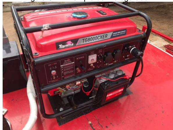
Figura 67 - Exemplo de motogerador.
